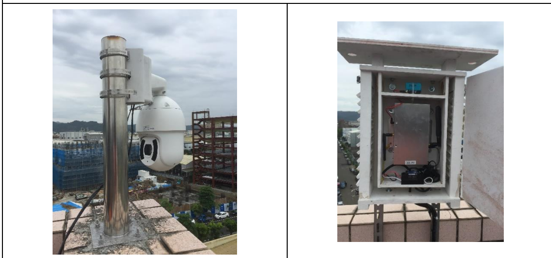
圖 3-11 大里場域-〇〇電信大里機房現場架設
