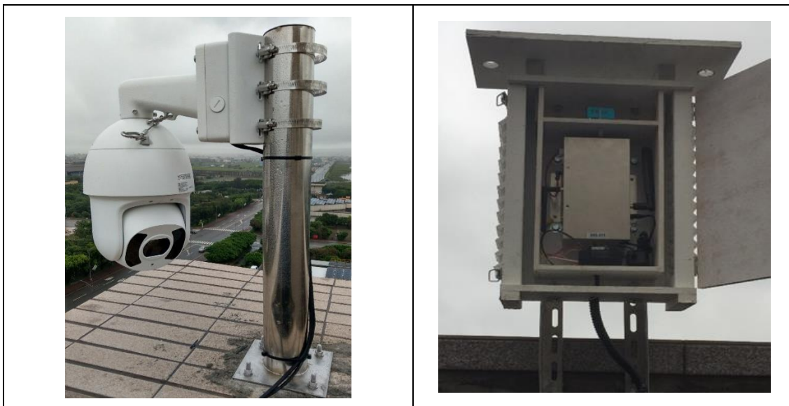
圖 3-3 關連場域-〇〇〇〇發電廠設備照片
