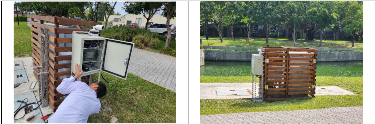
定點式水質監測站主機及攝影監控設備架設情形
