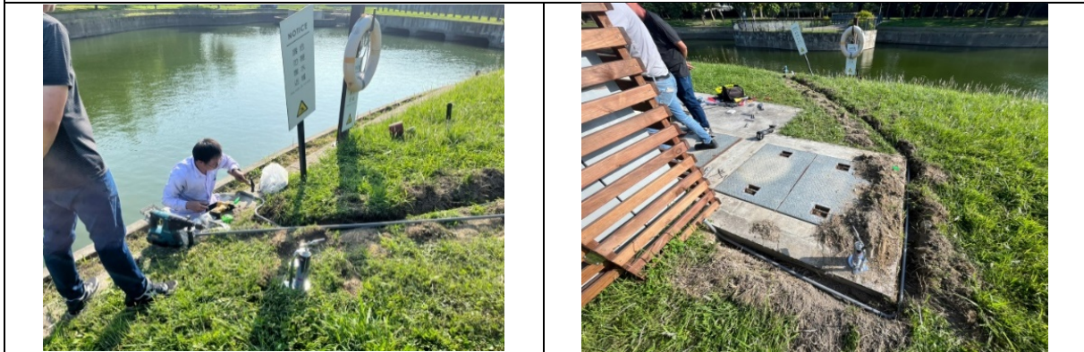
定點式水質監測站感測器電極線材地下埋管情形
