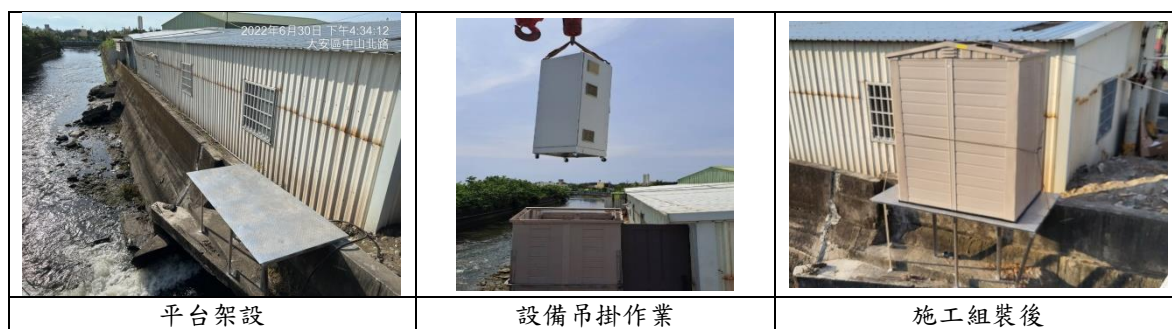
圖 3.2-8、大安港一號橋臭氧/超微細氣泡制菌模組設置與運轉情形
