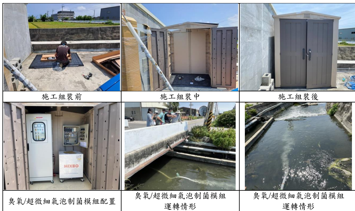
圖 3.2-7、南北八路橋臭氧/超微細氣泡制菌模組設置與運轉情形
