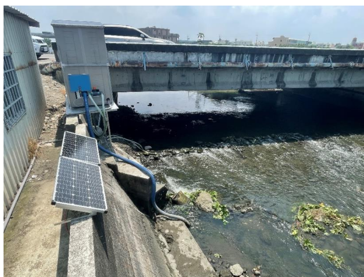
圖 3.2-11、大安港一號橋遠端監控太陽能系統
