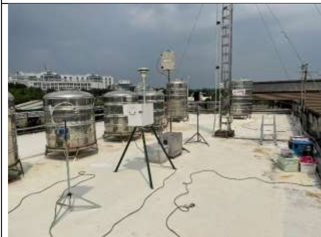
人工監測項目架設情形
