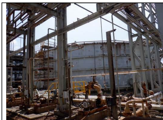
廢水設備現場情形
