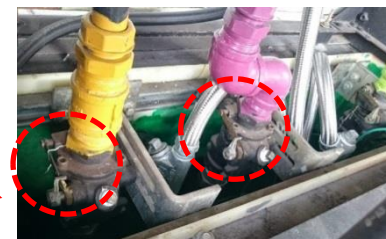
自動關閉設備(加油機)
