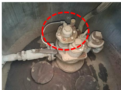
自動流量限制 (儲槽陰井)
