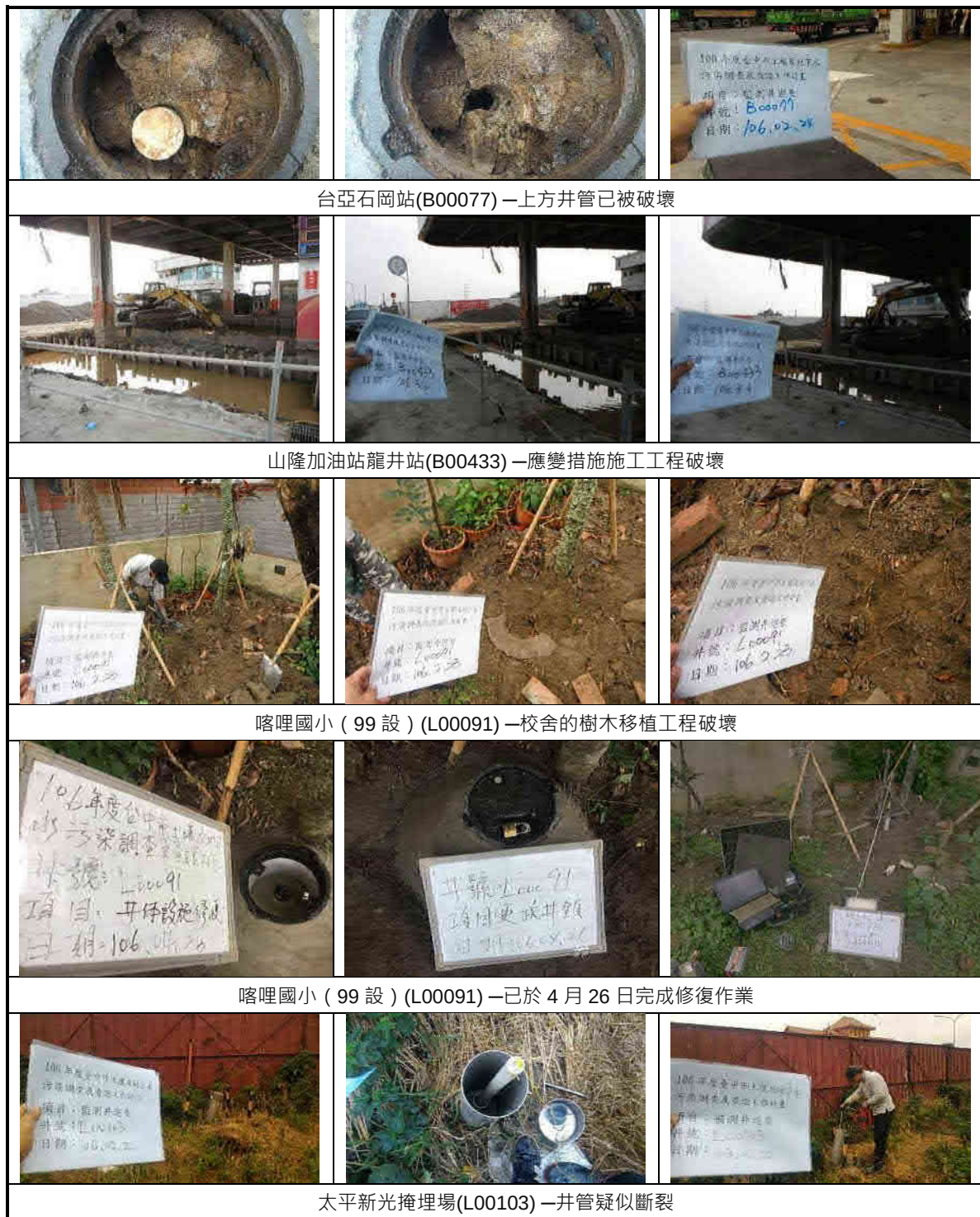
圖 4.4.1-1 上半年監測井巡查作業發現損毀及修繕過程相片
