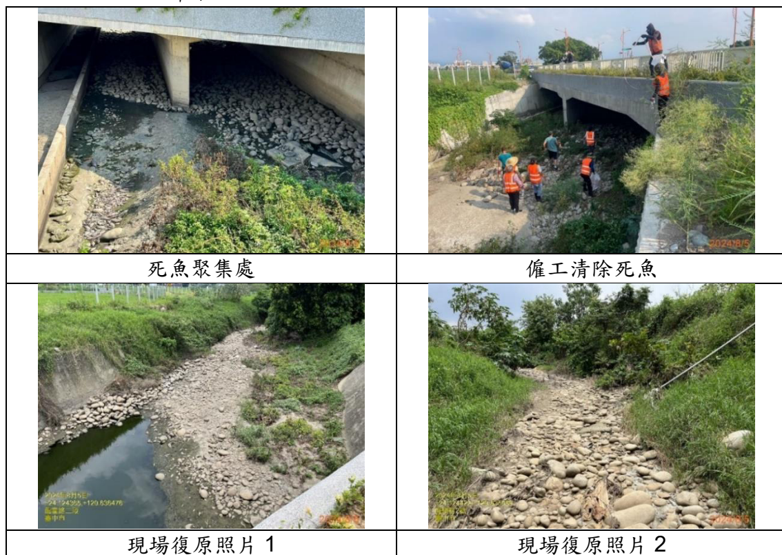
圖 3-1-13 南屯區舊南屯溪第十三期重劃區死魚事件處理情形
