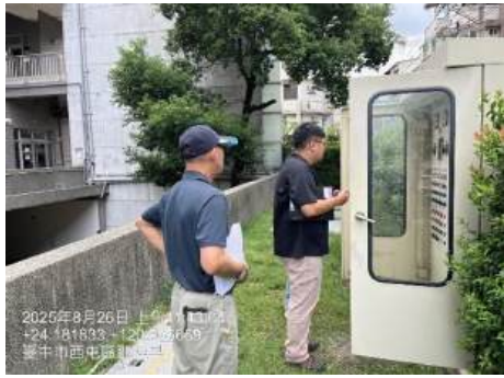
廢水處理電盤設定檢查
