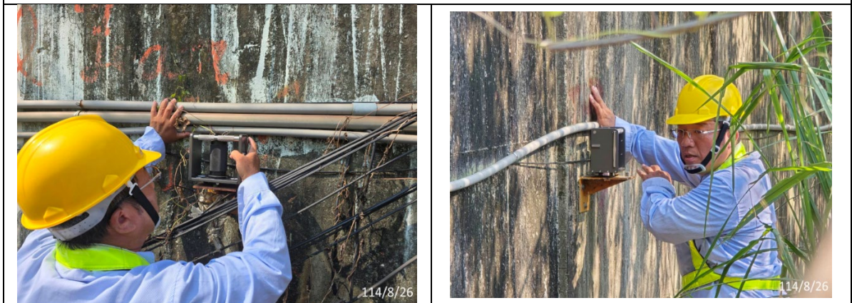
霧峰掩埋場需移開上方水管，才可量測正確數值
