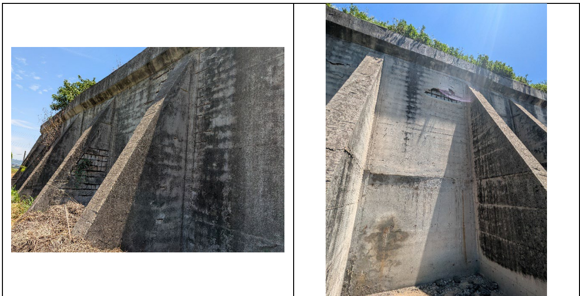
龍井掩埋場多處鋼筋外露
