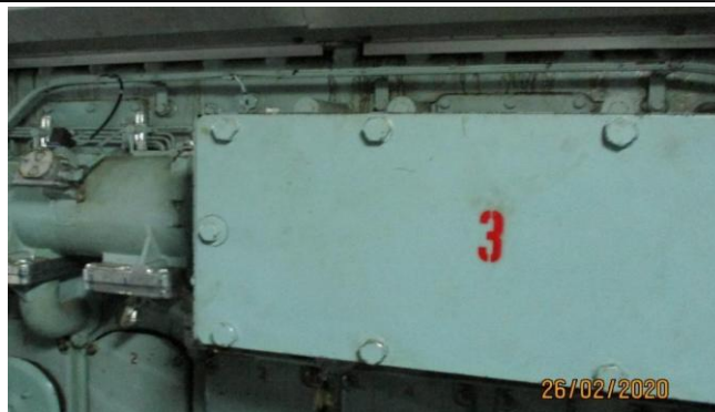
圖 3.7.3-5、現場正使用之發電機示機號
