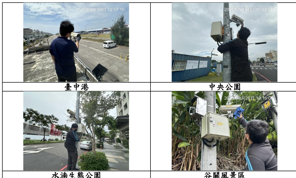
圖 4.2.2-1、車牌辨識系統實際維護狀況
