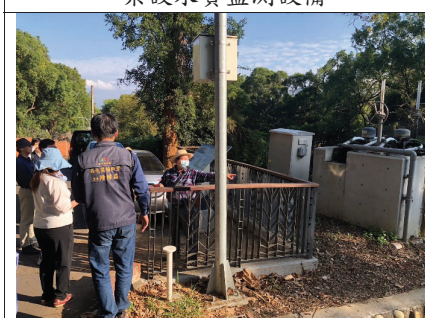
微水利發電設施
