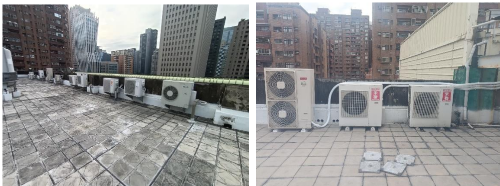
圖 3.3.3.7 文心第二市政大樓頂樓冷氣室外機分布情形
