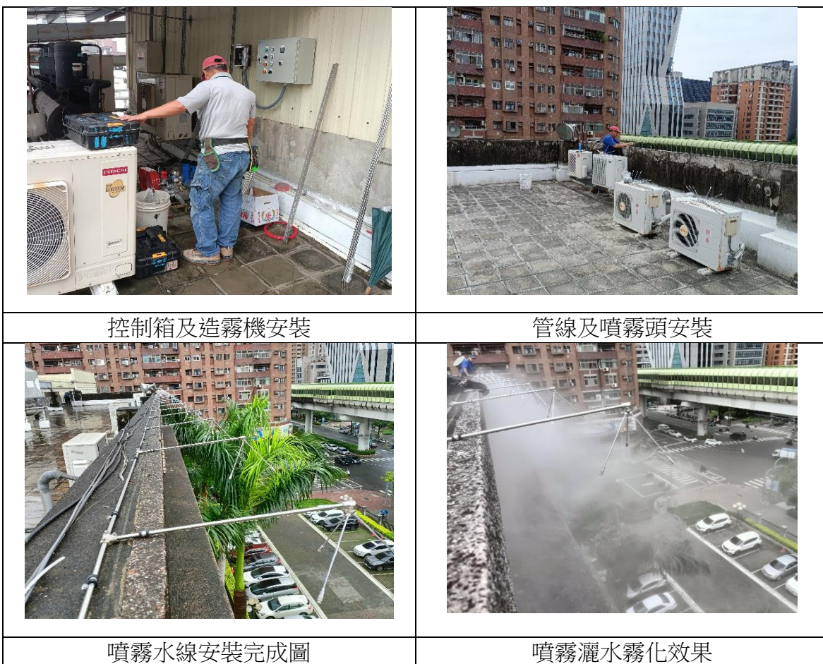
圖 3.3.3.17 自動化噴霧灑水設備施工照片
