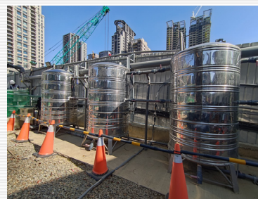
地下水貯存臨時水塔
