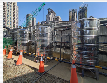
地下水貯存臨時水塔
