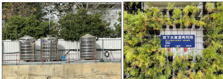
地下水貯存臨時水塔及取水龍頭
