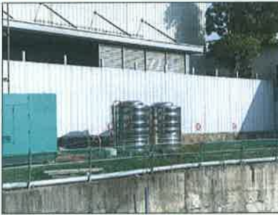
地下水貯存臨時水塔
