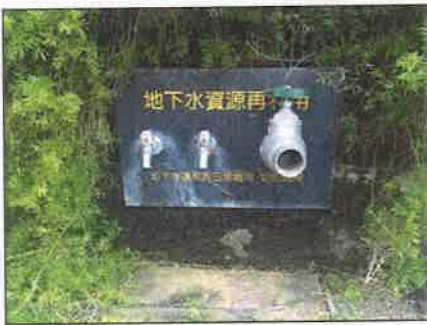
設置地下水貯存水箱及水龍頭
