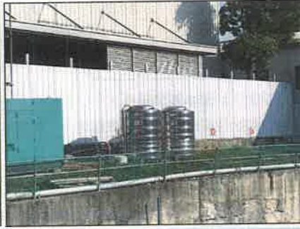
地下水貯存臨時水塔
