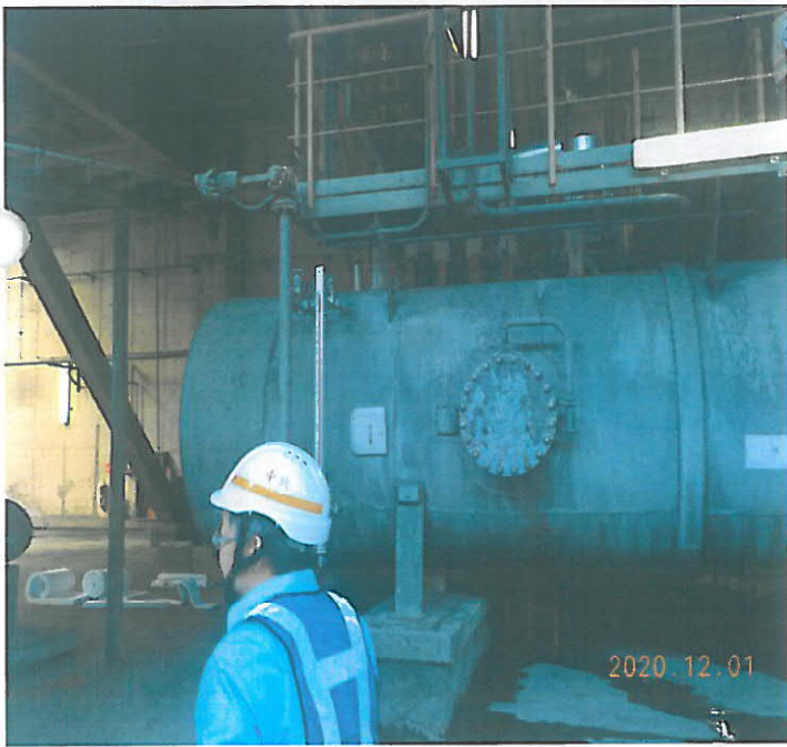
冷凝水槽滿水檢查
